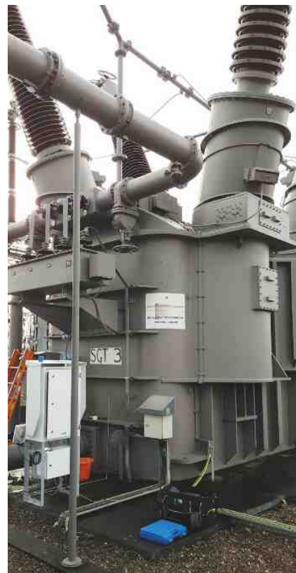
O Optimus DGA da Vaisala instalado em um transformador de eletricidade.
