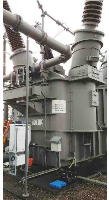
安装在电力变压器中的维萨拉 Optimus DGA。
