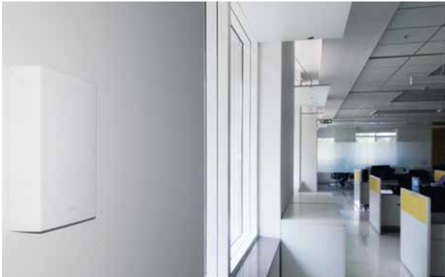
Installation von HLK-Sensoren in einem Bürogebäude von Infosys auf dem Bangalore Campus, Bangalore, Indien.
