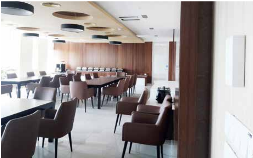
Installation eines HLK-Sensors in einem Speisesaal auf dem Bangalore Campus, Bangalore, Indien.
